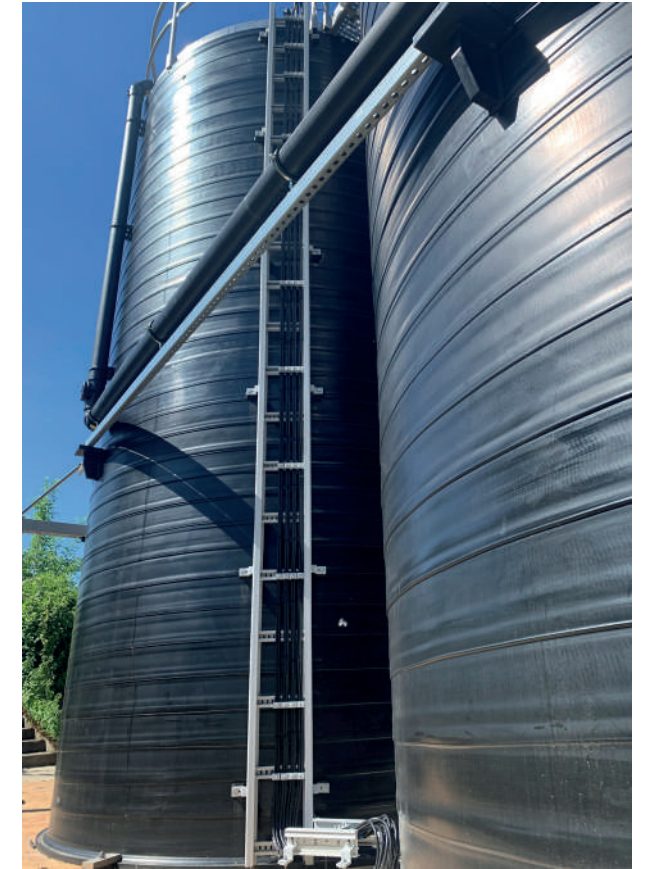
Tratamiento de aguas: EDAR
