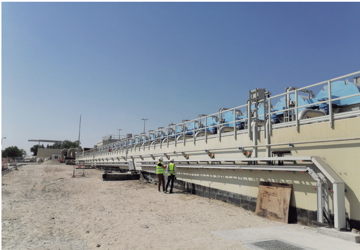
Tratamiento de aguas: EDAR
