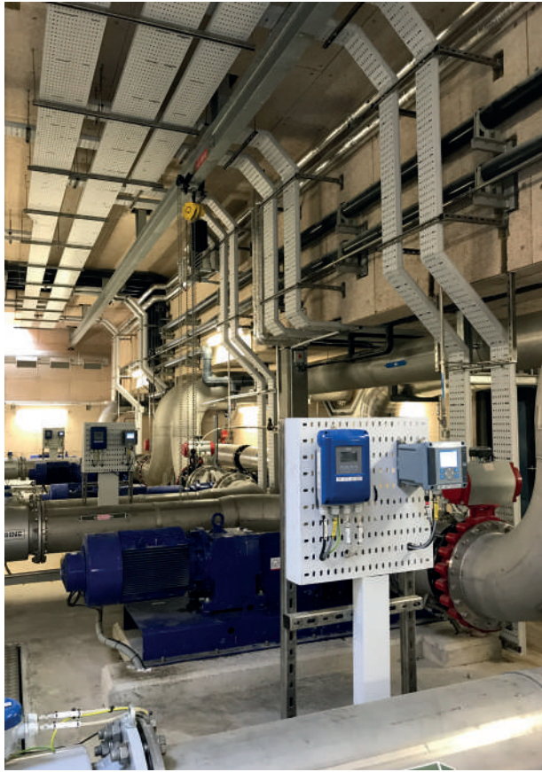
Tratamiento de aguas: EDAR
