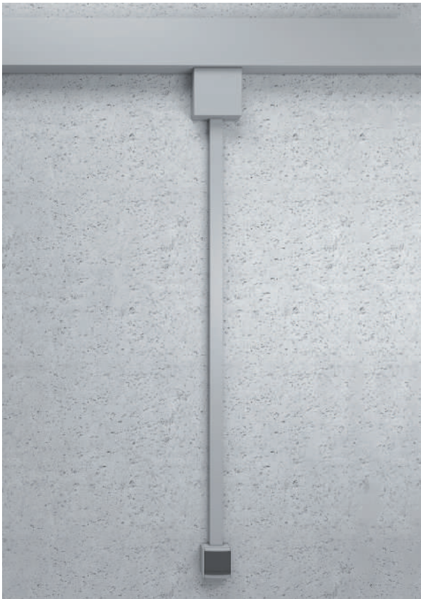
Nave industrial: alimentación de mecanismos
