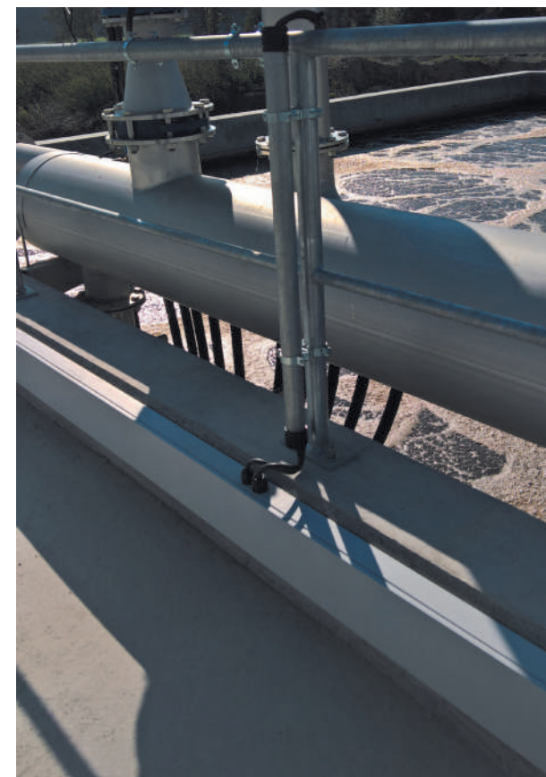
Tratamiento de aguas: EDAR
