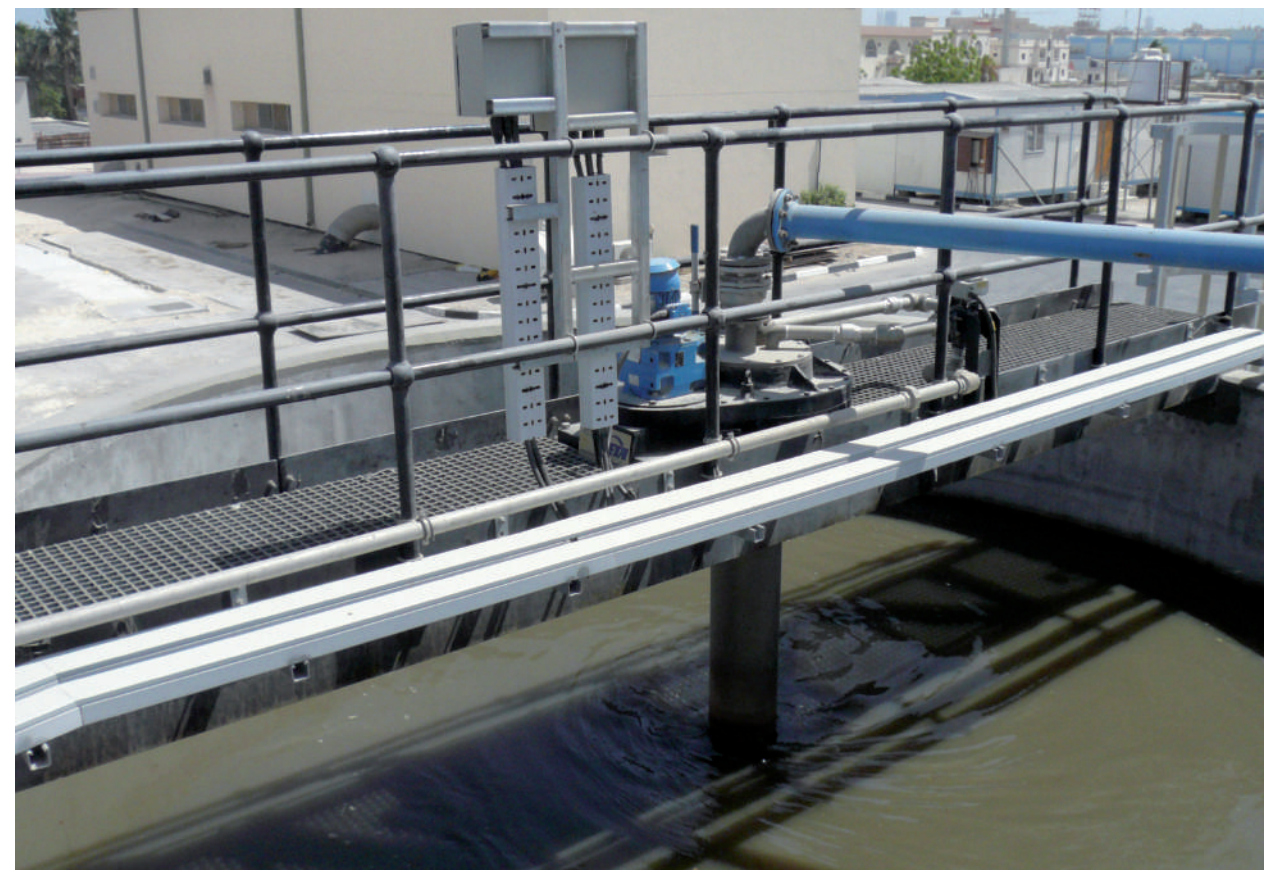
Tratamiento de aguas: EDAR
